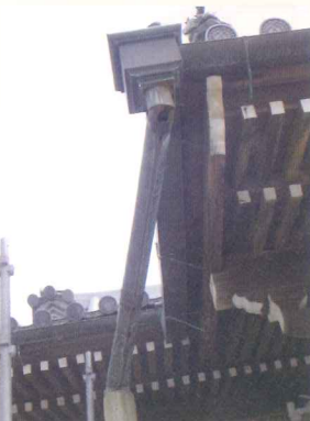
穴だらけで雨樋の役割をはたしていませんでした。
